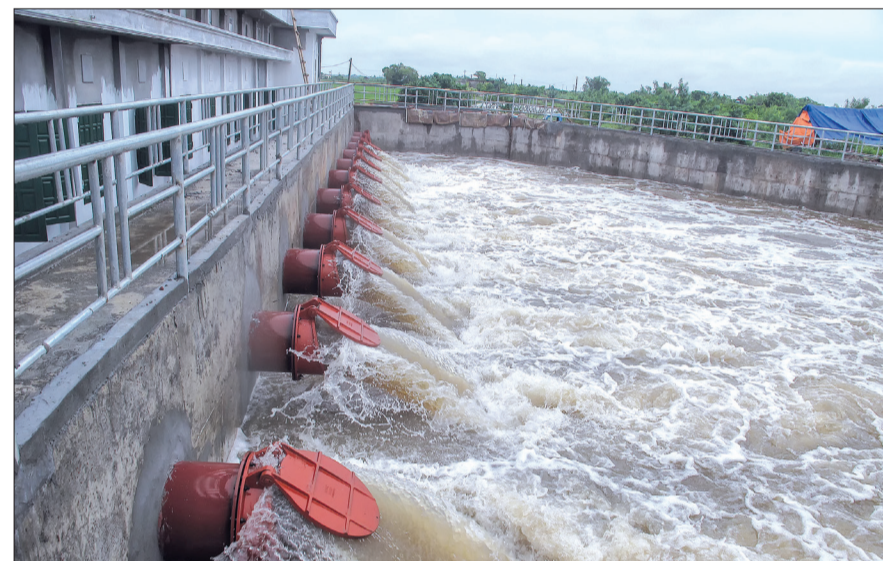
Hải công ty khai thác công trình thủy lợi Bắc và Nam Thái Bình đã vận hành 17 trạm bơm để lấy nước trong đợt xả nước hồ thủy điện đợt 1.
