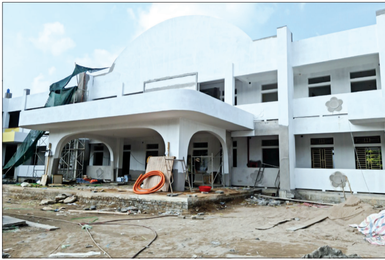
Trường Mầm non Trần Lâm khu 1 đang gấp rút hoàn thiện các hạng mục.
