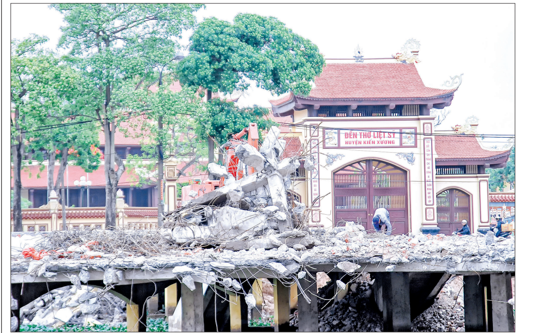
Toàn bộ công trình đài liệt sĩ huyện Kiến Xương đã được hạ giải ngày 8/11/2017.
