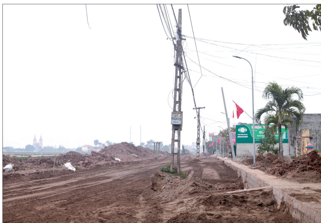
Dự án cải tạo, nâng cấp đường 221A còn gần 10 cột điện chưa di chuyển thuộc địa phận xã Nam Hưng (Tiền Hải).
