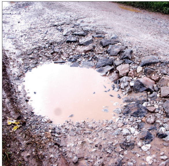
Mặt đê bị vỡ hoàn toàn kết cấu đá dăm láng nhựa.
