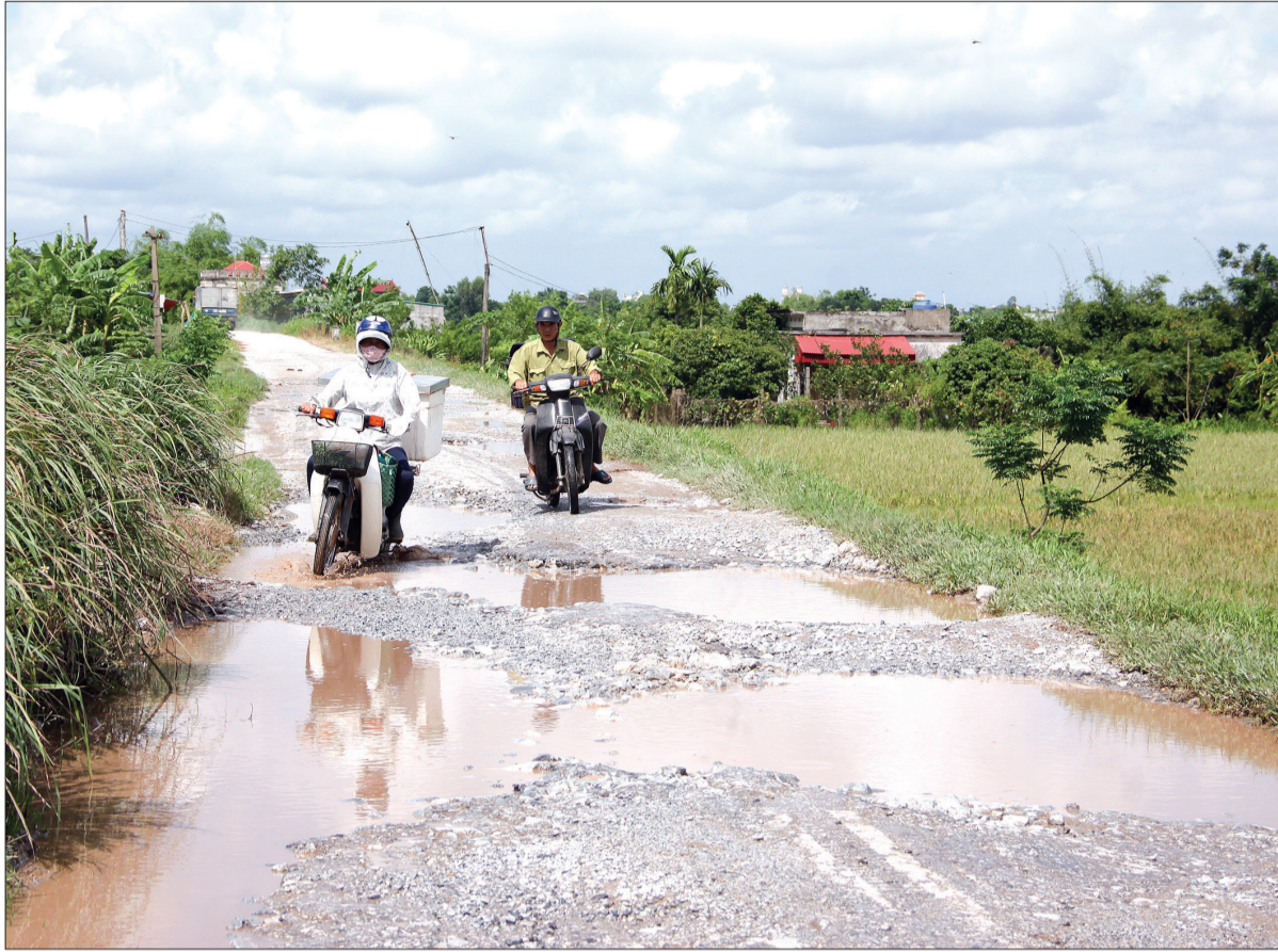
Mặt đê tả Hồng Hà II, đoạn qua địa phận các xã Vũ Đoài, Việt Thuận, Vũ Văn (Vũ Thu) xuống cấp nghiêm trọng gây khó khăn cho người tham gia giao thông.
