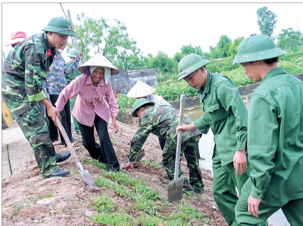
Cán bộ, chiến sĩ lực lượng vũ trang tỉnh cùng nhân dân tham gia cải tạo đường giao thông nông thôn.
