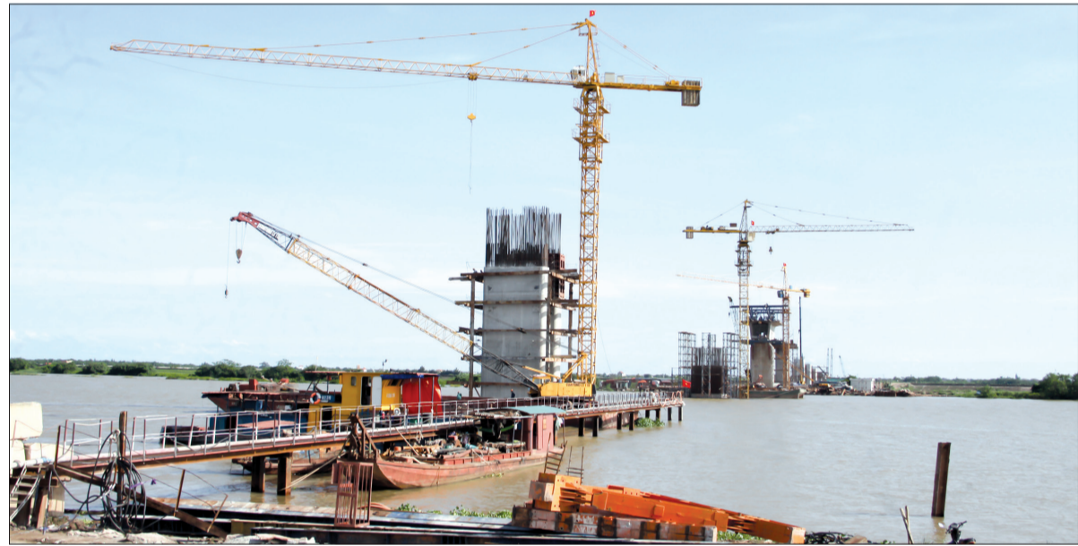
Thi công cầu vượt sông Trà Lý nối hai huyện Thái Thụy - Tiên Hải trong dự án tuyến đường bộ ven biển tỉnh Thái Bình.
