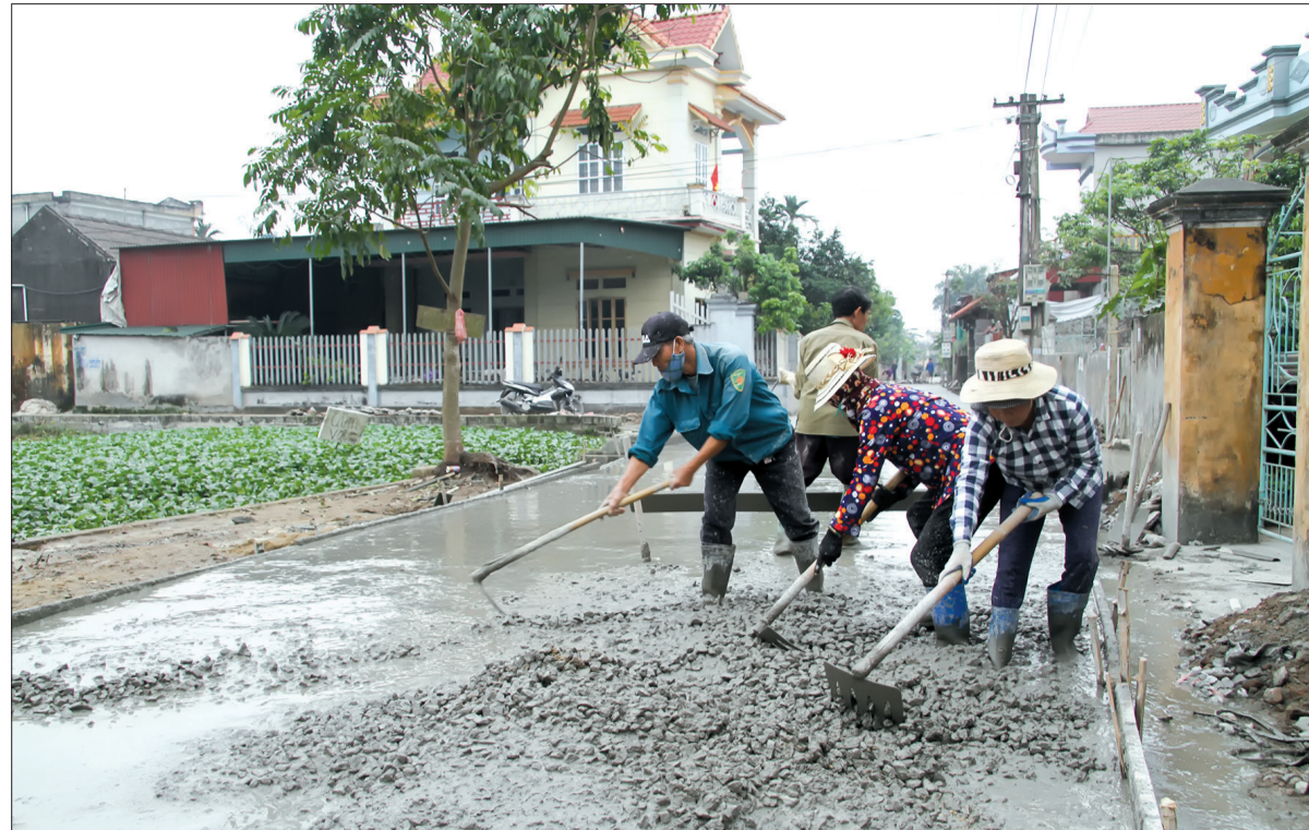
Thi công đường nông thôn mới tại xã Quỳnh Hông (Quỳnh Phụ).
