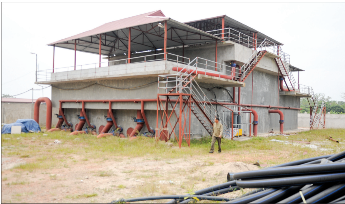
Nhà máy nước của Công ty Cổ phần Nước sạch Hưng Hà.
