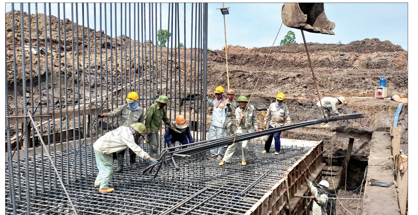
Công nhân Công ty Cổ phần Tập đoàn Phú Thành thi công cầu Cổ Rồng trên đường 221A.
