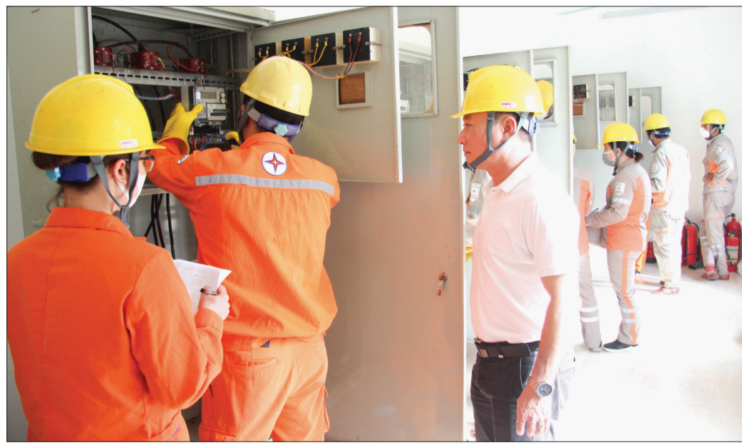
Công nhân Công ty Điện lực Thái Bình hoàn thành tốt bài thi thực hành trong kỳ thi nâng bậc.
