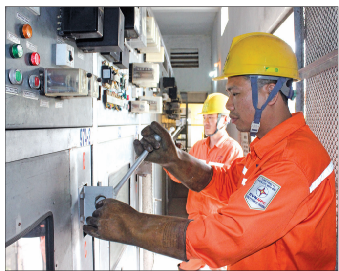
Công nhân Công ty Điện lực Thái Bình kiểm tra hệ thống điện bảo đảm vận hành an toàn.
