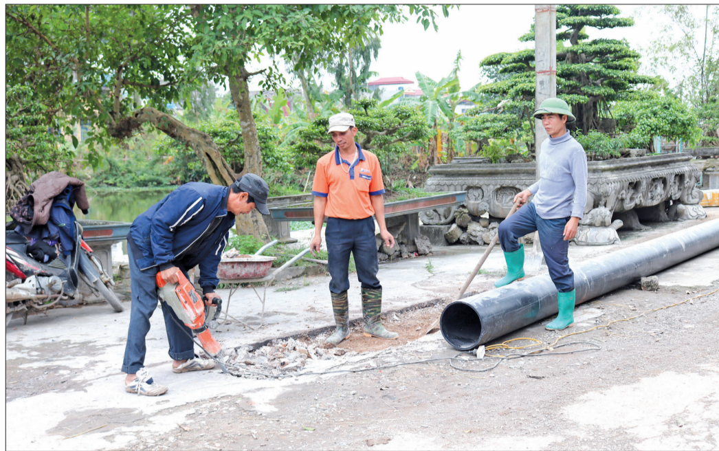
Công ty TNHH Xây dựng Phú Đông Thành thi công tuyến đường ống dài 8km từ sông Hòa về nhà máy để bảo đảm chất lượng nguồn nước cung cấp cho nhân dân.
