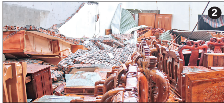
Ảnh 1, 2 - Lở xoáy làm tốc mái, đổ tường, sập nhà gây thiệt hại tài sản của người dân.
