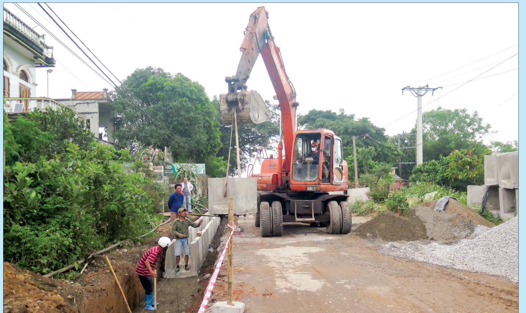
Thi công dự án cải tạo, nâng cấp đường 219 đoạn Thanh Tân - Vũ Quý.
