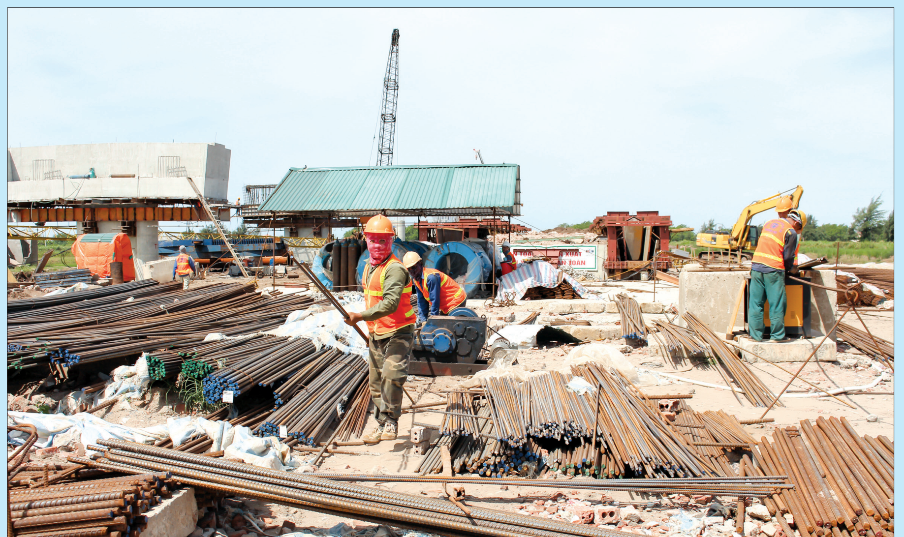
Công nhân làm việc tại công trường xây dựng cầu sông Hồng dưới thời tiết nắng nóng.
