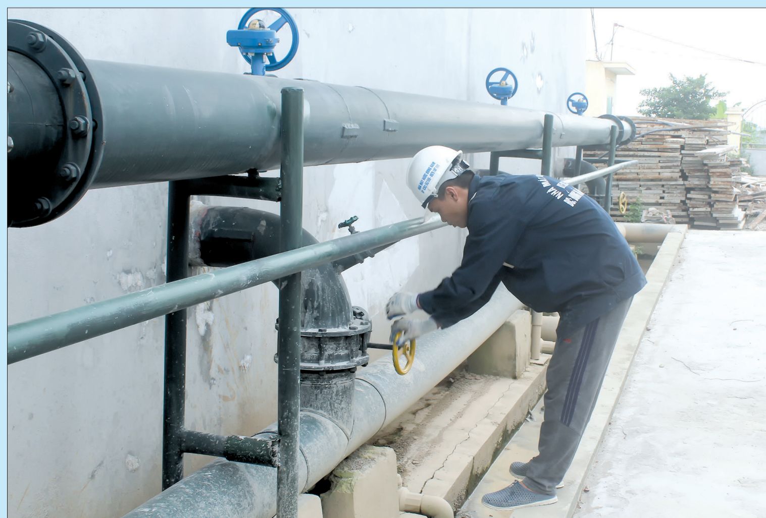
Công nhân Công ty TNHH Thương mại Đồ Gia Bảo vận hành hệ thống cấp nước sạch.
