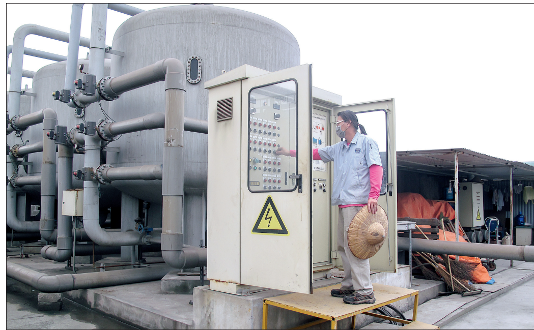
Trạm xử lý nước thải của Công ty Texhong.
