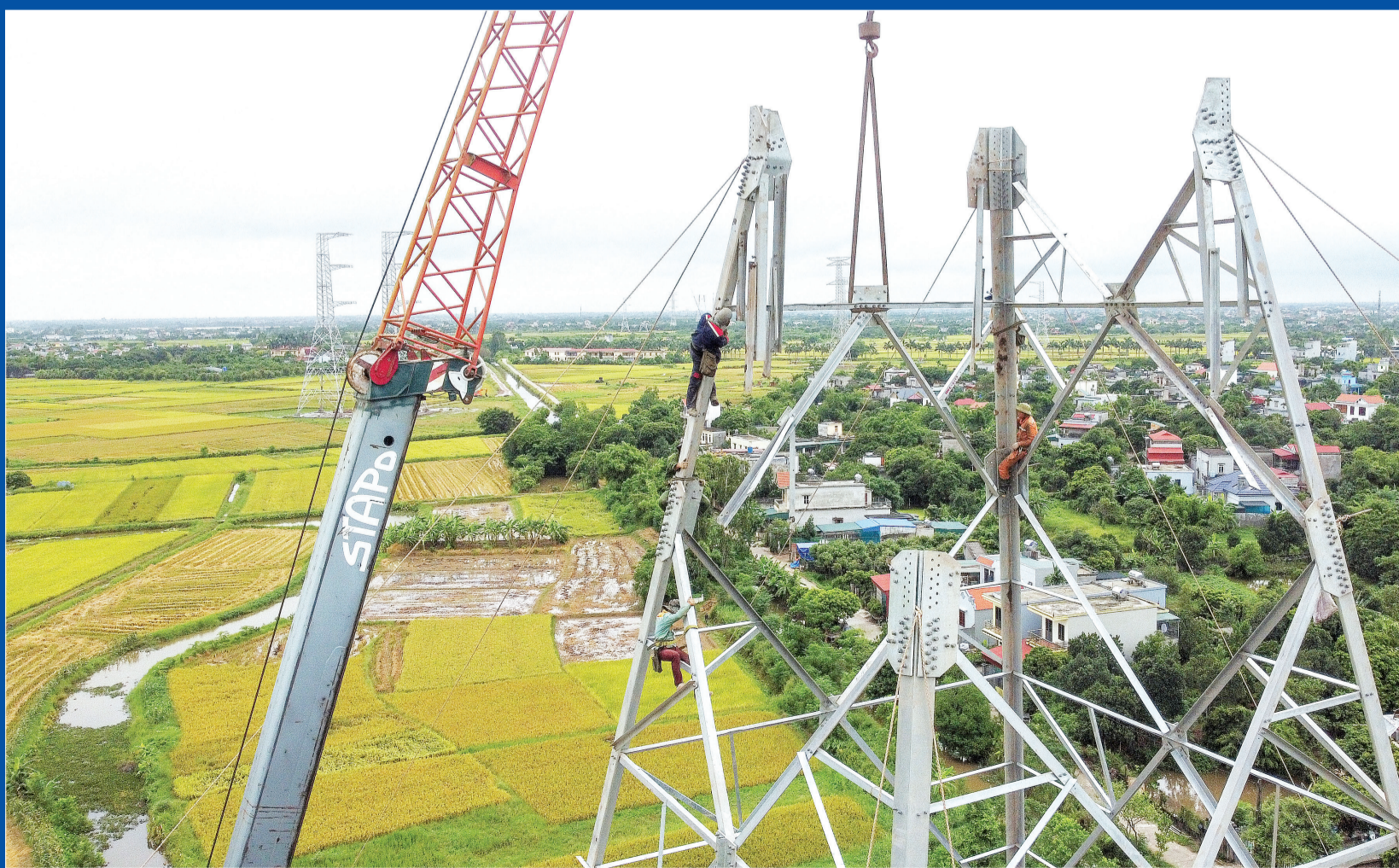
Với sự hỗ trợ "4 tại chỗ" của tỉnh Thái Bình, đơn vị thi công yên tâm đẩy nhanh tiến độ thi công đường dây 500 kV mạch 3 trên địa bàn.
