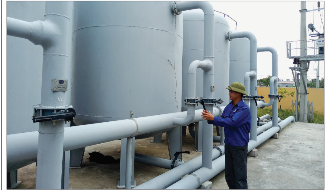
Hệ thống xử lý nước sạch tại nhà máy nước sạch sinh hoạt Thái Thịnh.
