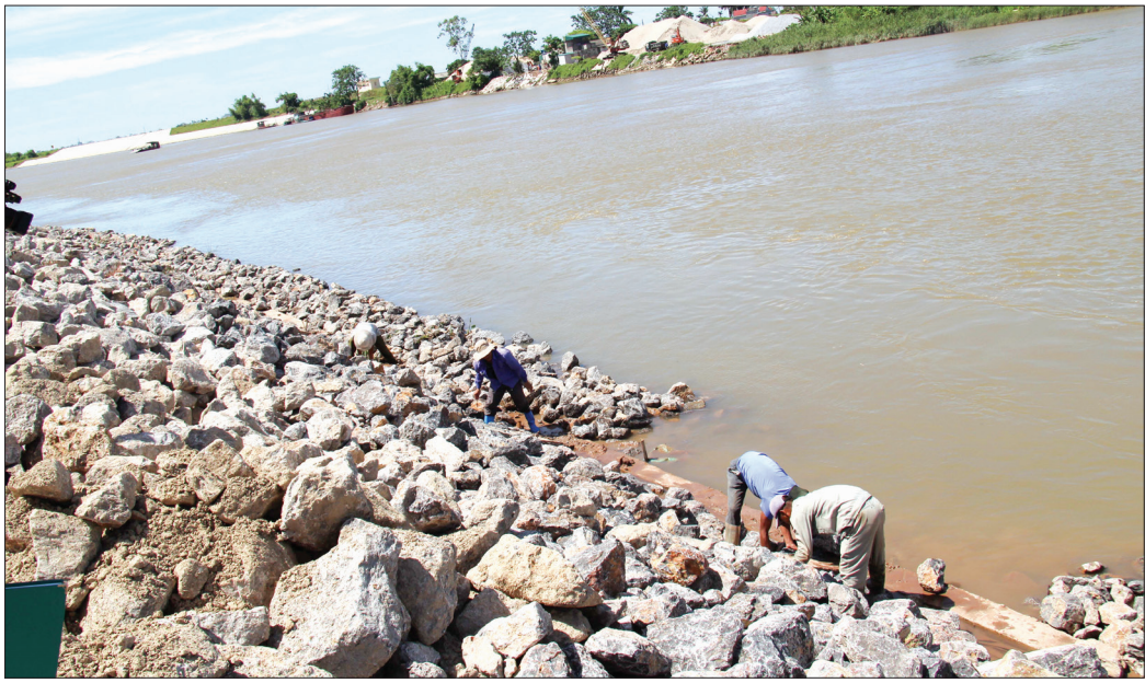
Công nhân Công ty TNHH Nam Thái thi công kè An Lập, xã Hồng Giang (Đông Hưng).
