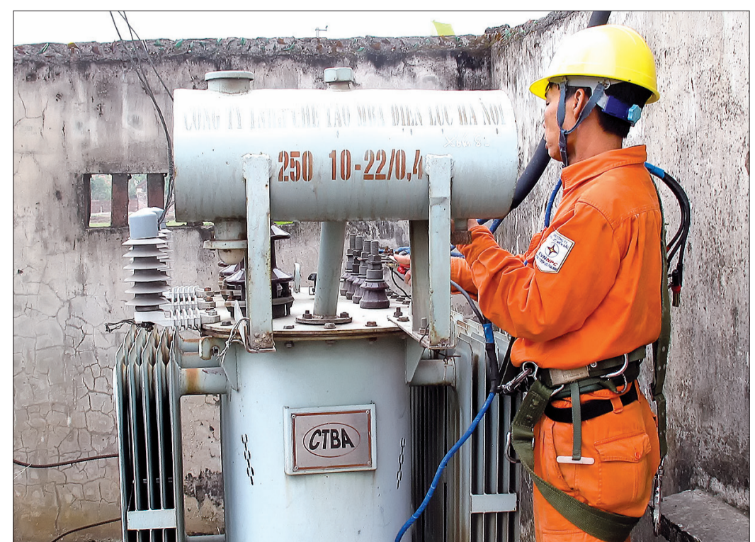
Kiểm tra tình trạng hoạt động của trạm biến áp trên địa bàn xã Thái Hòa (Thái Thụy).
