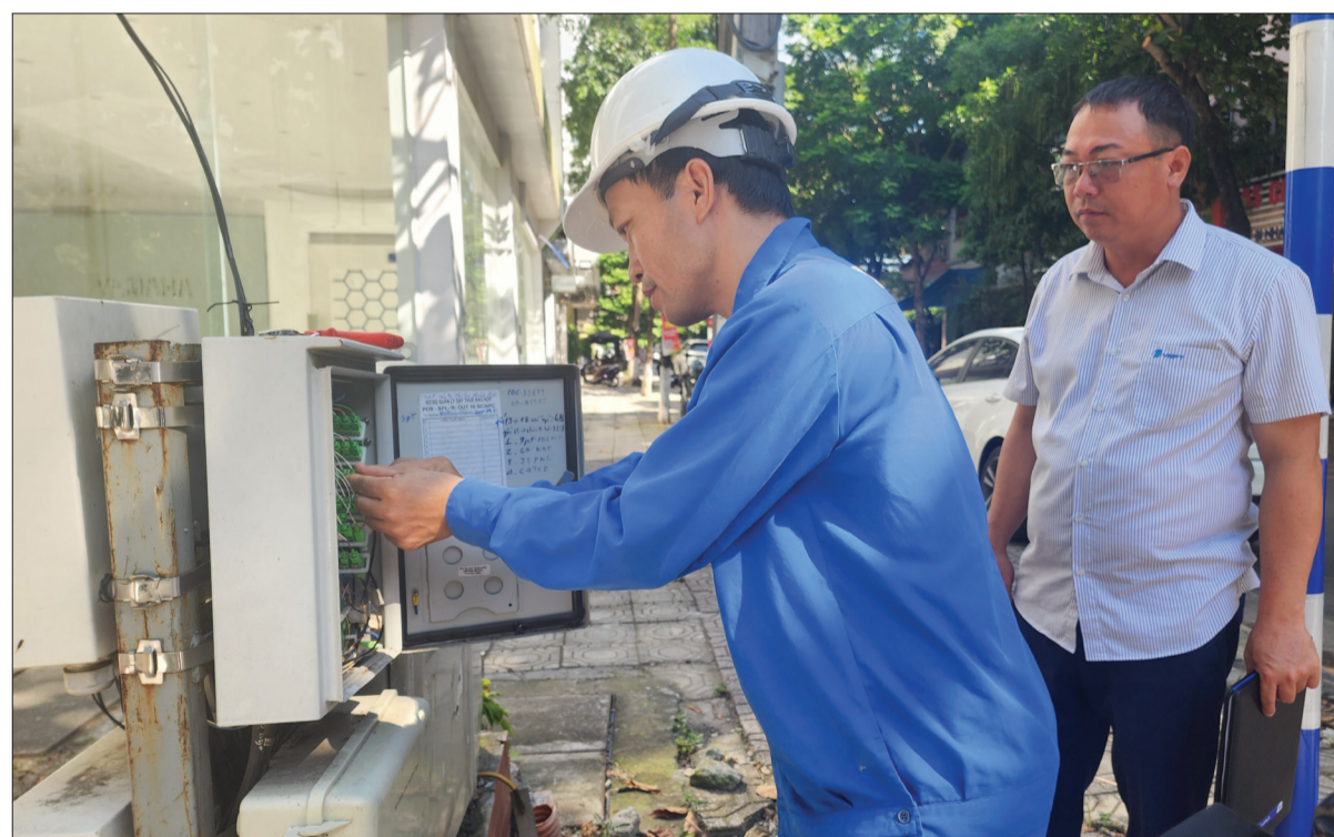
Công nhân VNPT thành phố Thái Bình kiểm tra hệ thống cáp viễn thông đã được hạ ngầm tại tuyến phố Bồ Xuyên.
