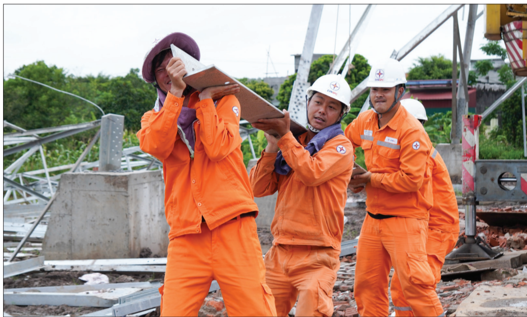
Công nhân Công ty Điện lực Thái Bình tham gia lắp cấu kiện cột điện dự án đường dây 500kV.
