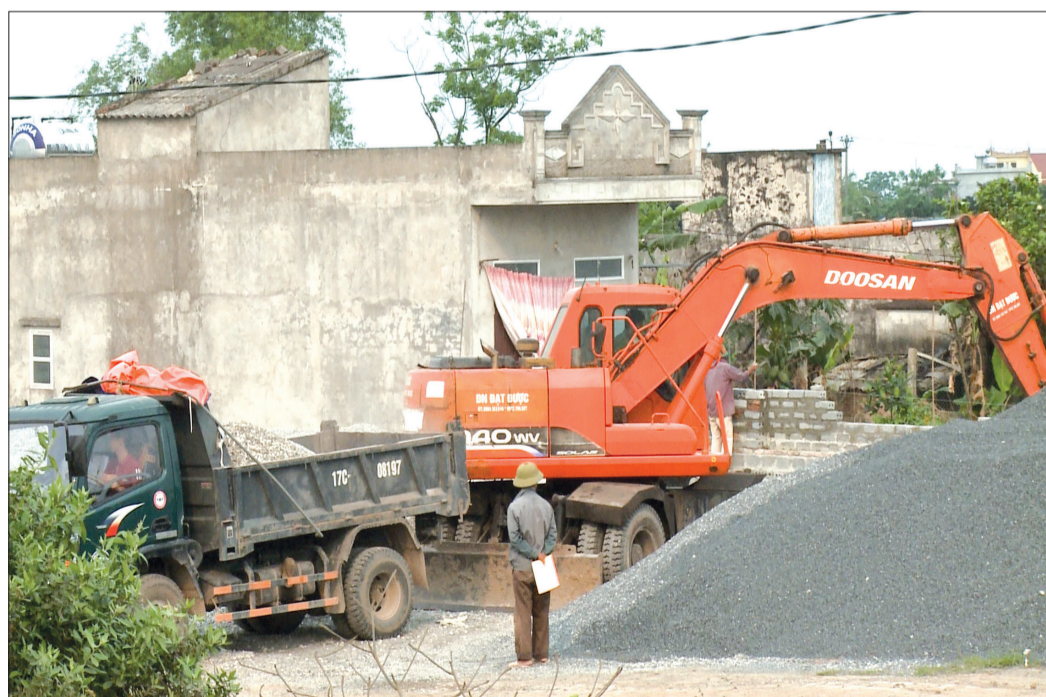
Cùng với vi phạm ngoài đê, Công ty TNHH Thương mại và Xây dựng Đạt Được còn tự ý san lấp phía trong đê để tập kết vật liệu khi chưa được cấp phép.
