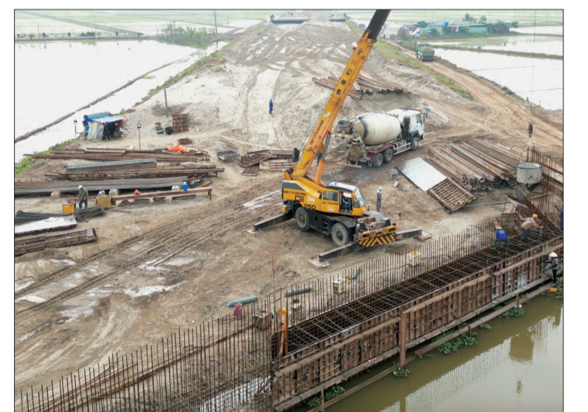
Thi công hạng mục cầu sông Gốc thuộc tuyến số 3, đường trục kết nối.
