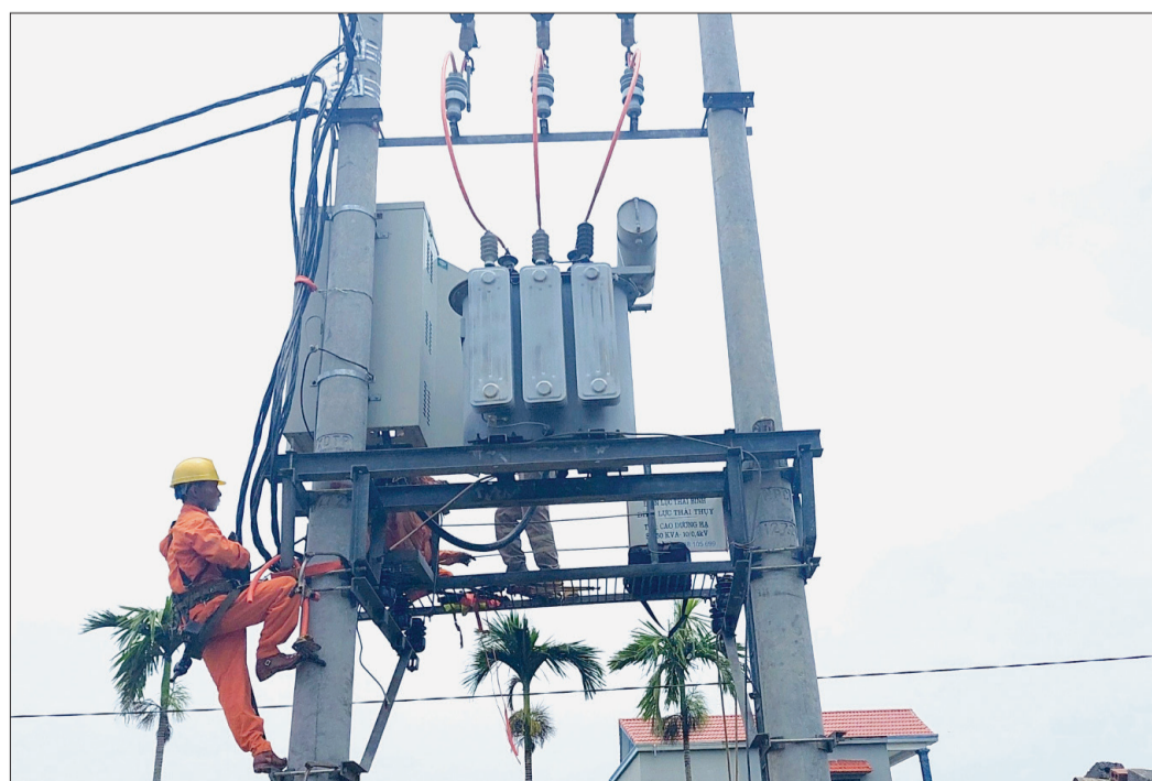
Công nhân Điện lực Thái Thụy kiểm tra định kỳ trạm biến áp.
