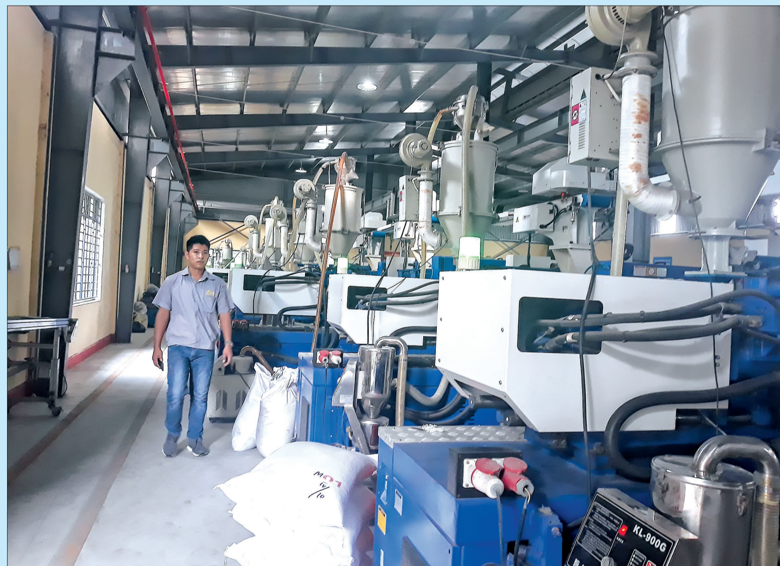
Dây chuyền sản xuất của Công ty TNHH Điện cơ Aidi (khu công nghiệp Gia Lễ, Đông Hưng).
