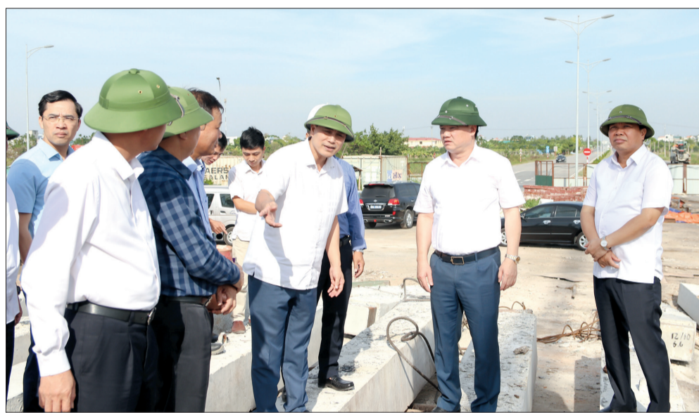
Đồng chí Nguyễn Khắc Thận, Phó Bí thư Tỉnh ủy, Chủ tịch UBND tỉnh kiểm tra tiến độ dự án đầu tư xây dựng tuyến đường vành đai phía Nam thành phố Thái Bình, đoạn từ cầu gang S1 đến đường Chu Văn An kéo dài.
