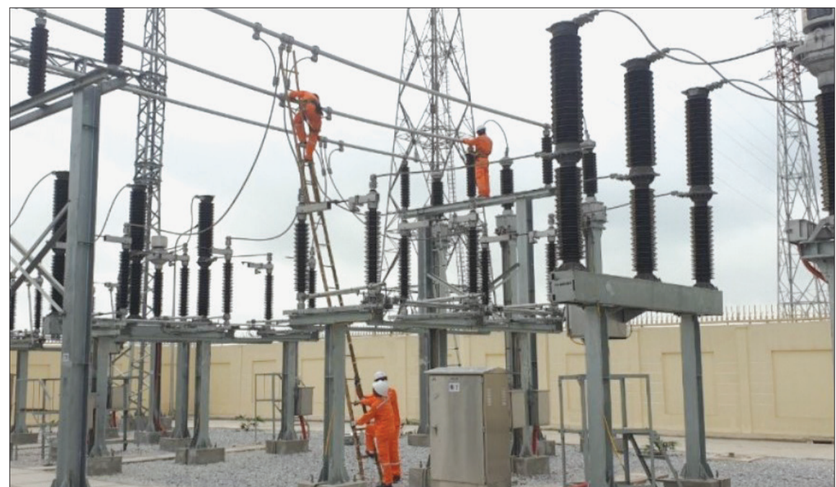
Công nhân Công ty Điện lực Thái Bình kiểm tra thí nghiệm định kỳ tại trạm biến áp Châu Giang (Đông Hưng).
