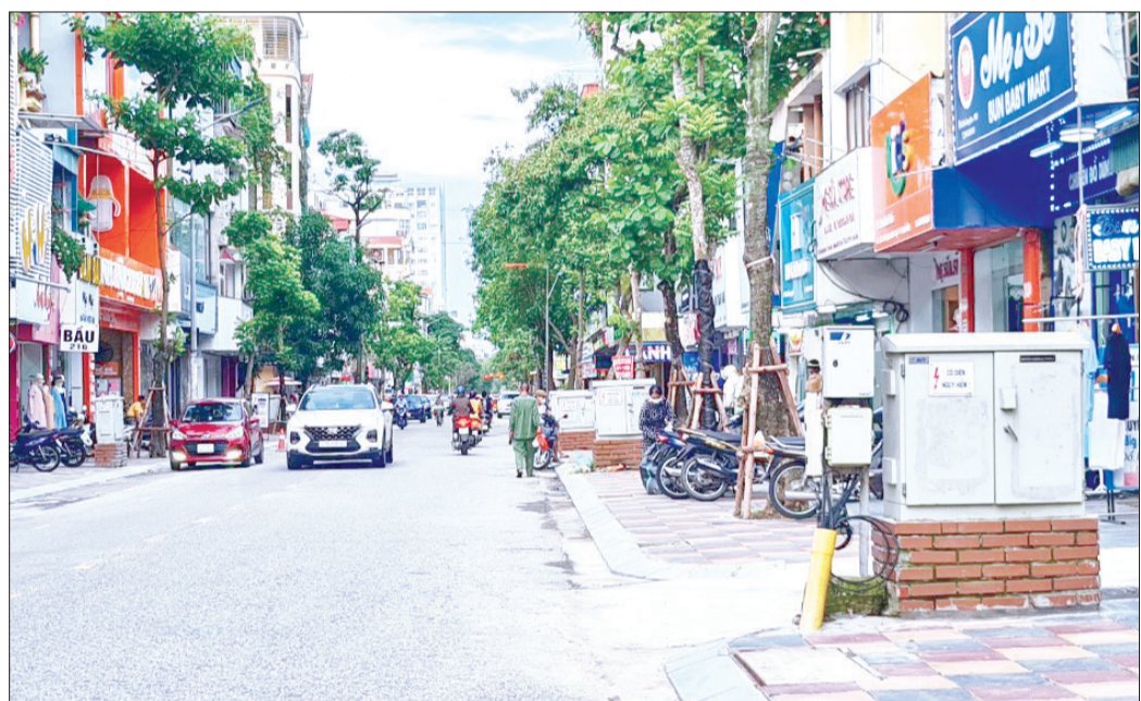
Lưới điện và cáp viễn thông trên đường Trần Hưng Đạo (thành phố Thái Bình) đã được hạ ngầm bảo đảm an toàn, làm đẹp đường phố.
