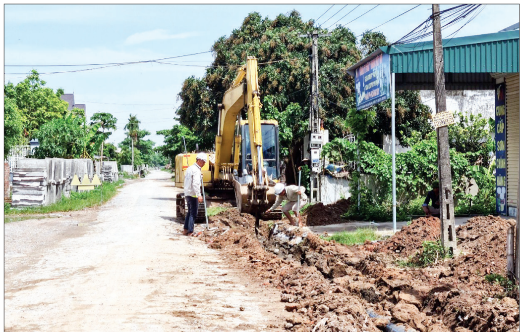
Đường ĐH55 huyện Đông Hưng cơ bản hoàn thành công tác giải phóng mặt bằng.
