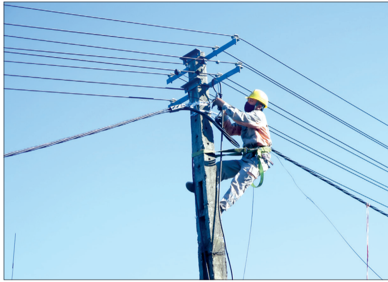
Công ty Điện lực Thái Bình không ngừng nâng cấp hệ thống truyền tải điện bảo đảm cấp điện ổn định, an toàn.
