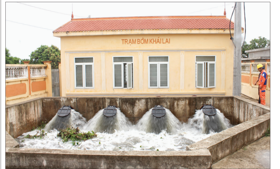
Trạm bơm Khai Lai (xã Thái Hồng, huyện Thái Thụy) sẵn sàng tiêu ứng trong mùa mưa bão.
