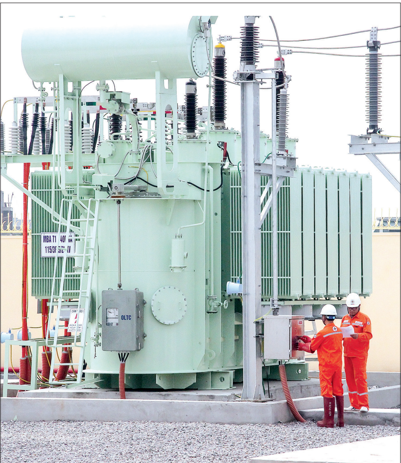
Việc đầu tư xây mới các trạm biến áp 110kV không người trực đã góp phần phát triển lưới điện thông minh.
