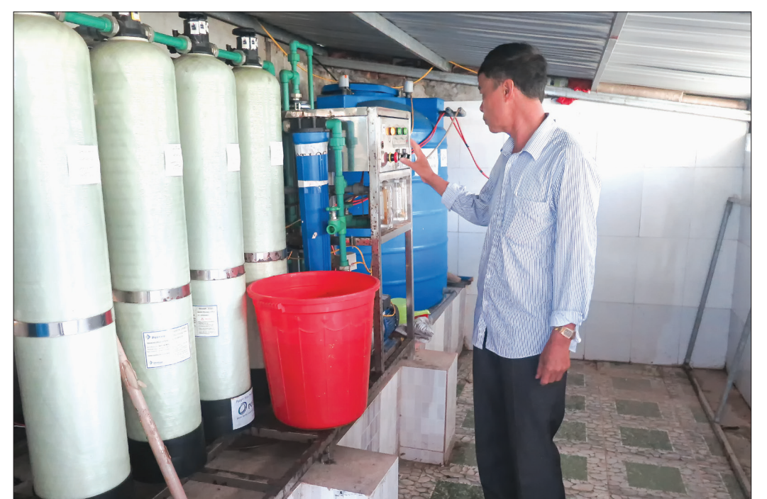
Hệ thống lọc nước RO lắp đặt ở UBND xã để cung cấp cho các trường học.
