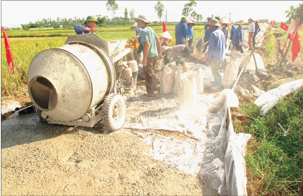
Xây dựng cơ sở hạ tầng nông thôn tại xã Thụy Phong (Thái Thụy).
