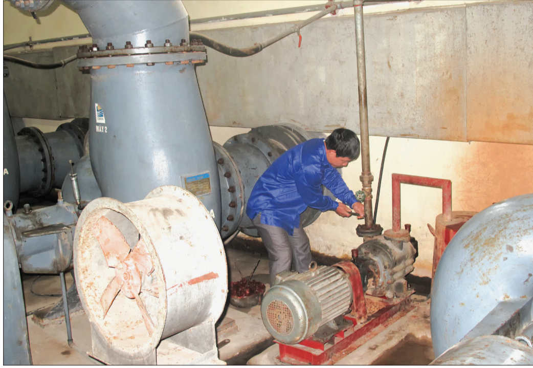
Công nhân trạm bơm Thống Nhất (Tiền Hải) kiểm tra máy bơm phục vụ tưới, tiêu vụ mùa.
