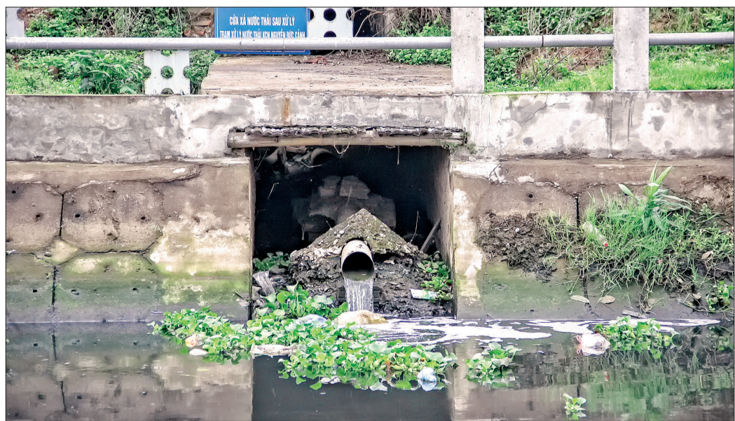
Cửa xả nước thải sau xử lý của Trạm xử lý nước thải Nguyễn Đức Cảnh, khu công nghiệp Nguyễn Đức Cảnh, thành phố Thái Bình.
