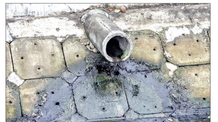
Nước thải từ khu dân cư xã Phú Xuân, thành phố Thái Bình xả ra sông Bạch.
