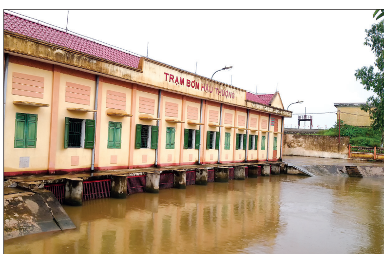
Trạm bơm Hậu Thượng sẵn sàng bơm tiêu úng bảo vệ cây trồng.
