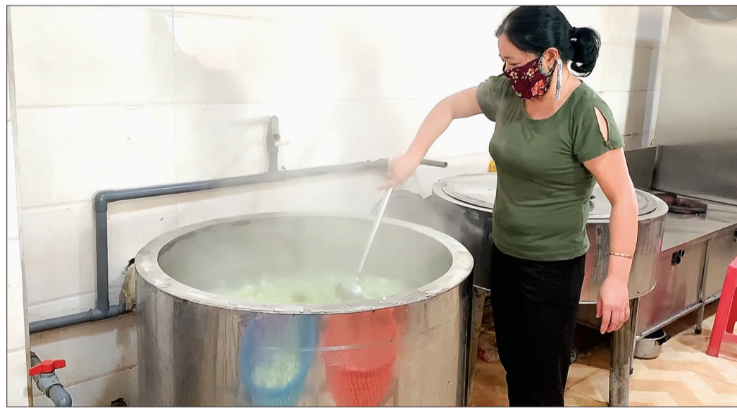
Việc sử dụng nồi hơi còn giúp Công ty May Đạt Đăng bảo đảm bữa ăn cho công nhân ngay cả khi mất điện.
