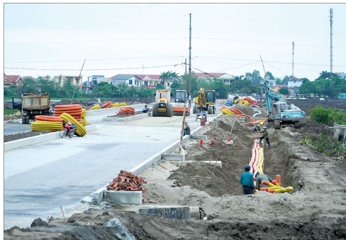
Công ty Cổ phần Green i-Park tập trung thi công hạ tầng giao thông phục vụ thu hút đầu tư vào khu công nghiệp Liên Hà Thái.
