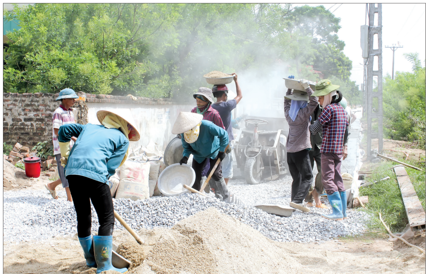
Người dân xã Hợp Tiến (Đông Hưng) chung sức làm đường nông thôn mới.
