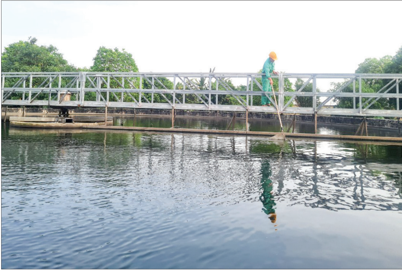
Trạm xử lý nước thải sinh hoạt thành phố Thái Bình.
