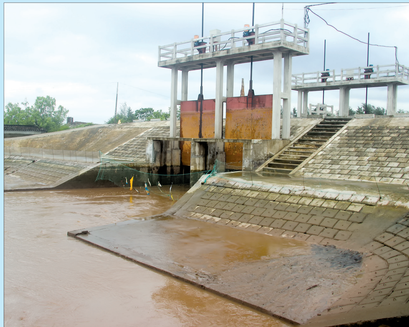
Các cống dưới đê được mở để tiêu thoát nước bảo đảm cho sản xuất vụ mùa.
