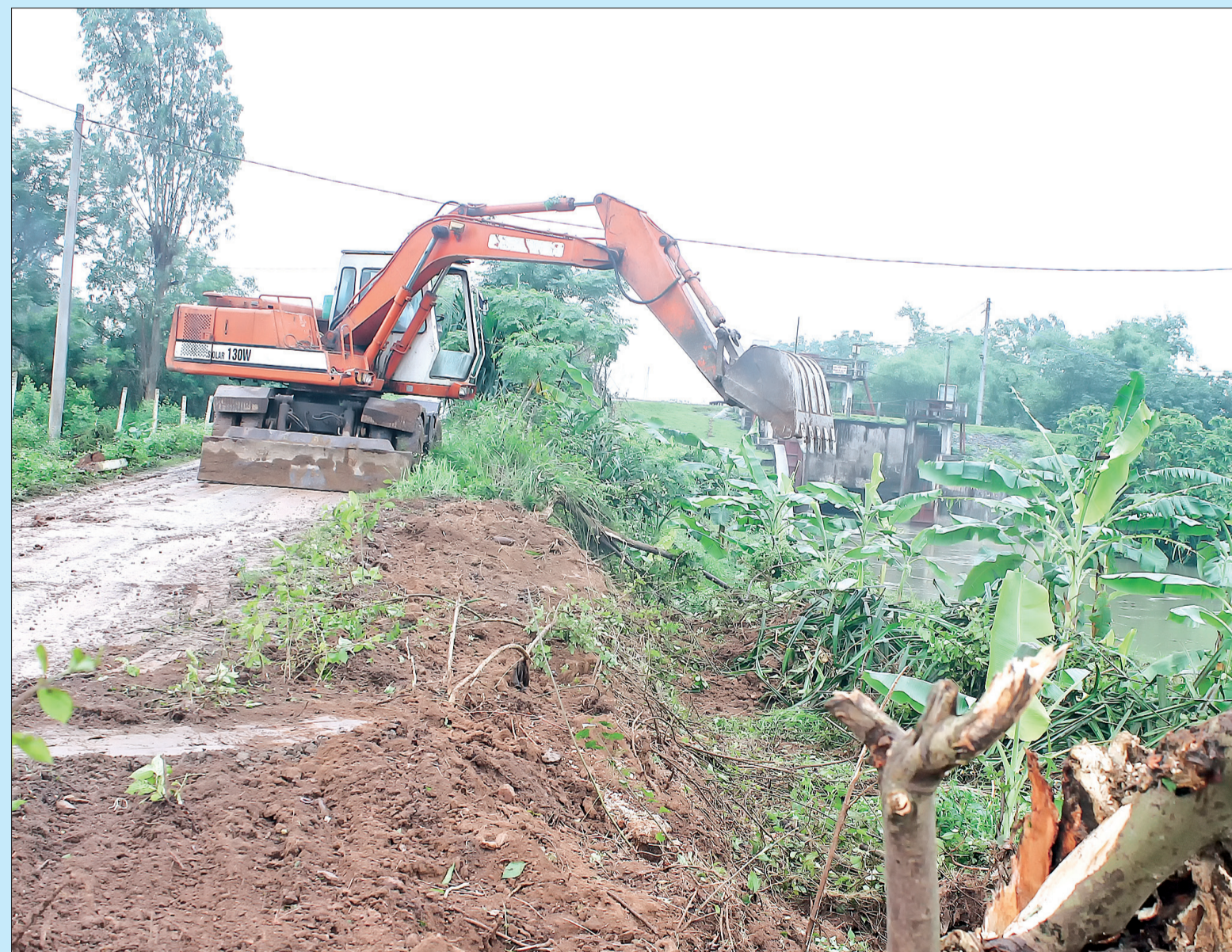
Xã Hiệp Hòa (Vũ Thư) giải tỏa, phát quang khu vực cống Nang (cống dưới đê hữu Trà Lý).
