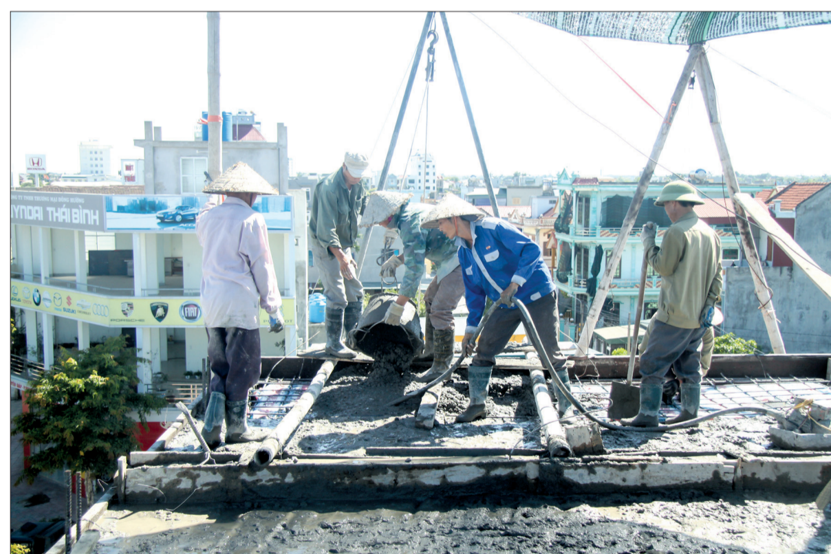
Thợ xây dựng làm việc dưới ánh nắng gay gắt (phường Hoàng Diệu, thành phố Thái Bình).
