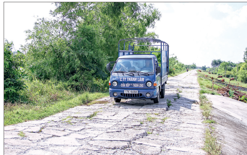
Mặt đê tả Trà Lý đoạn qua địa phận xã Đông Hòa hiện đã xuống cấp nghiêm trọng nhưng chưa được tu bổ, sửa chữa.
