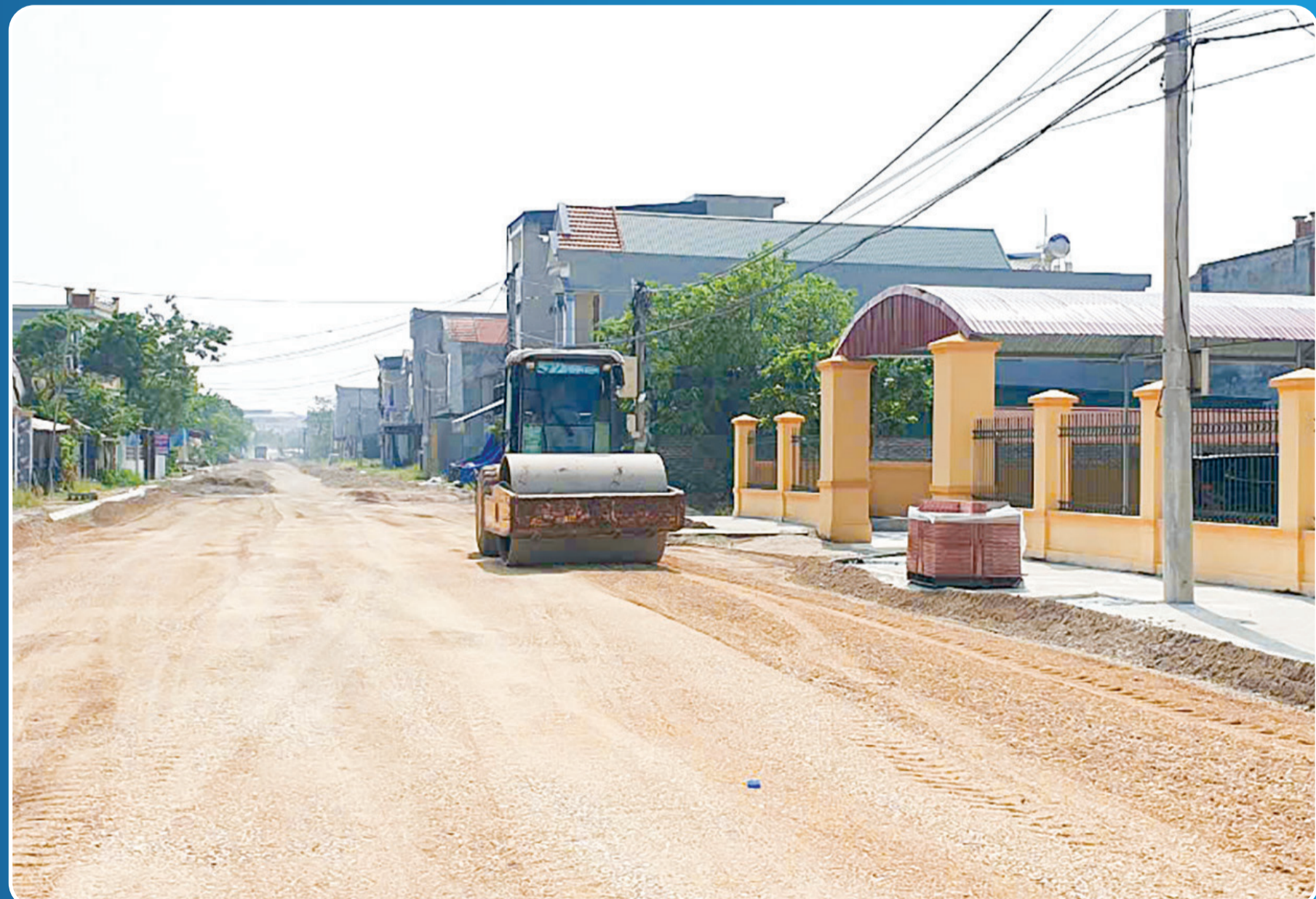
Đơn vị thi công huy động nhân lực, phương tiện đẩy nhanh tiến độ hoàn thành dự án tuyến đường tỉnh ĐT.452 đoạn qua xã Quỳnh Mỹ (Quỳnh Phụ).
