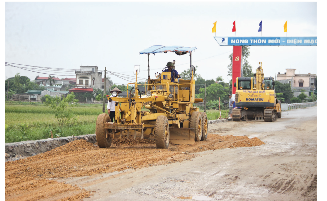
Nhà thầu huy động nhân lực, phương tiện đẩy nhanh tiến độ thi công tuyến đường ĐH.75.
