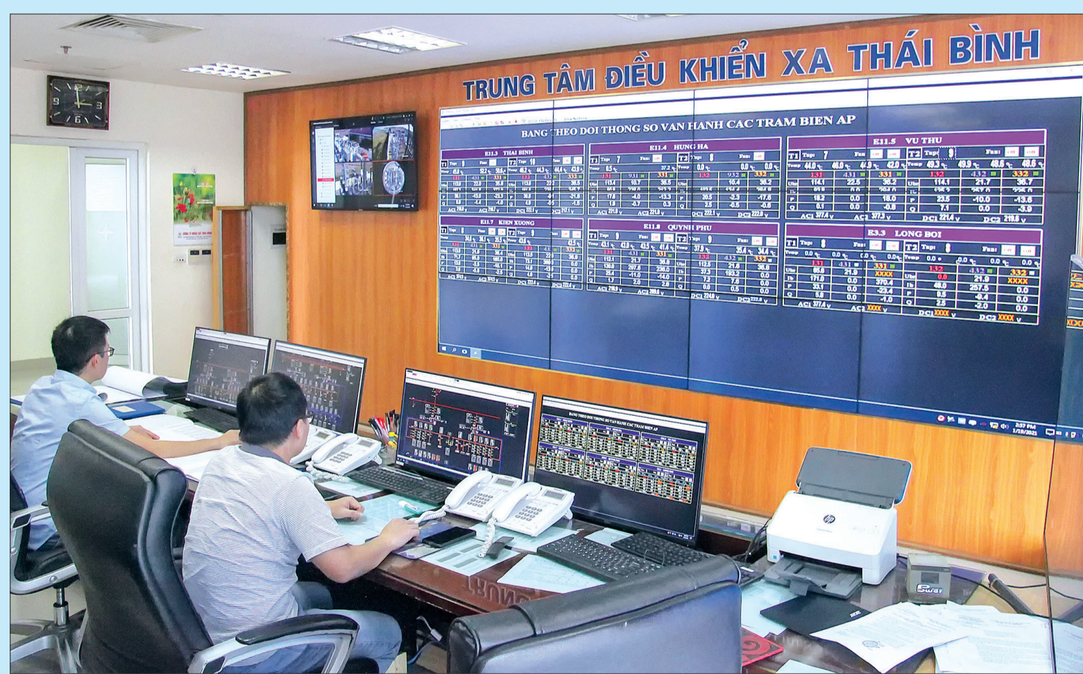
Cán bộ Trung tâm điều khiển xa Công ty Điện lực Thái Bình giám sát hệ thống truyền tải cung cấp điện.
